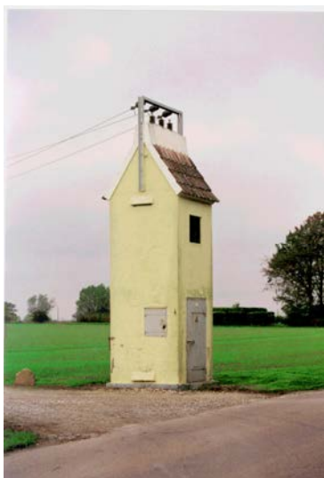
Transformatorårn, Mindehøjvej, Rødvig
